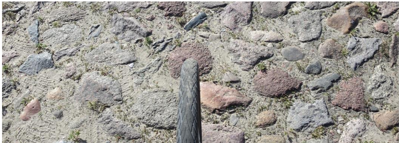
Fahradunfreundliche Pflasterung auf verschiedenen Teilstrecken zwischen den Dörfern.
